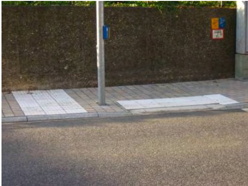
Bild 8: Doppelquerung mittels Systembordstein – Blinde mit Hochbord (linke Seite), Gehbehinderte an Nullabsenkung (rechte Seite) (Foto: Lemke)
